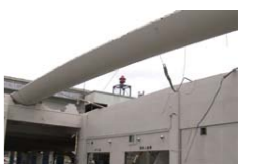
屋上サイレンの柱にしがみついて助かった
